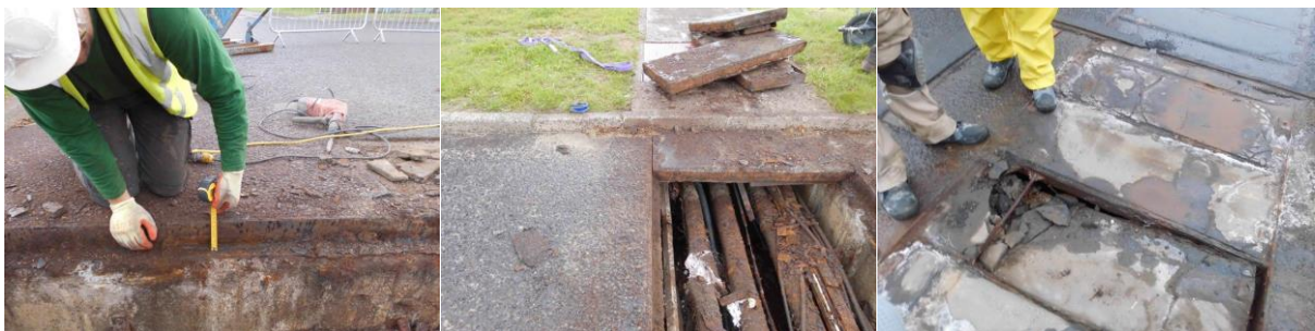
Oude situatie: zwaar gecorrodeerde Trench Covers
