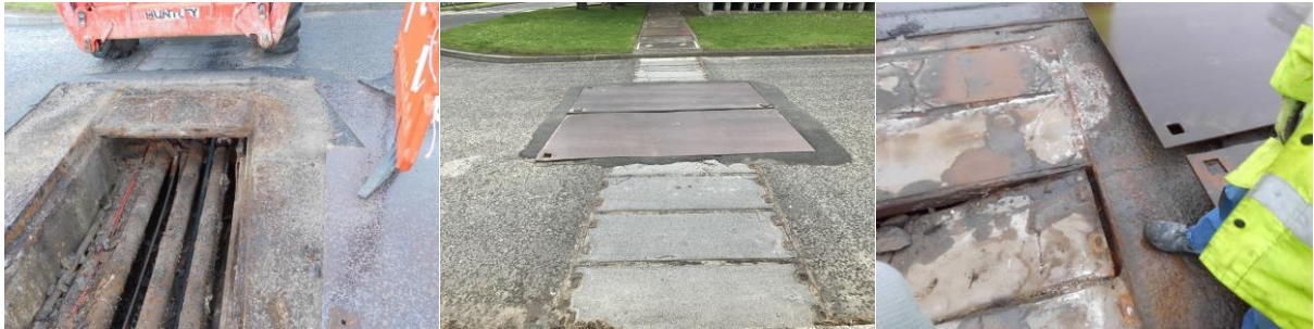
Oude situatie: zwaar gecorrodeerde Trench Covers
